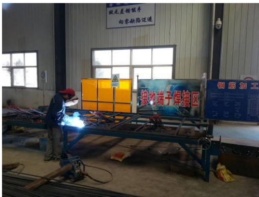
图 5.2.2-3 接地端子焊接区
